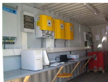
Innenausstattung des Containers für Forschungszwecke mit unterschiedlichen Wechselrichtern und der Batterie
